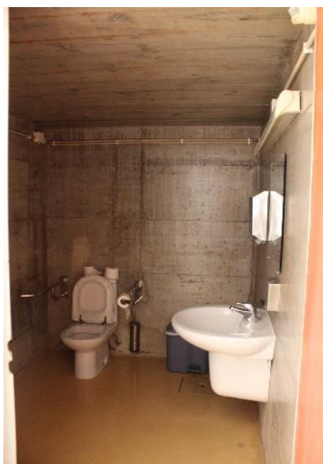
Figura 32 Instalações sanitárias para mobilidade reduzida
