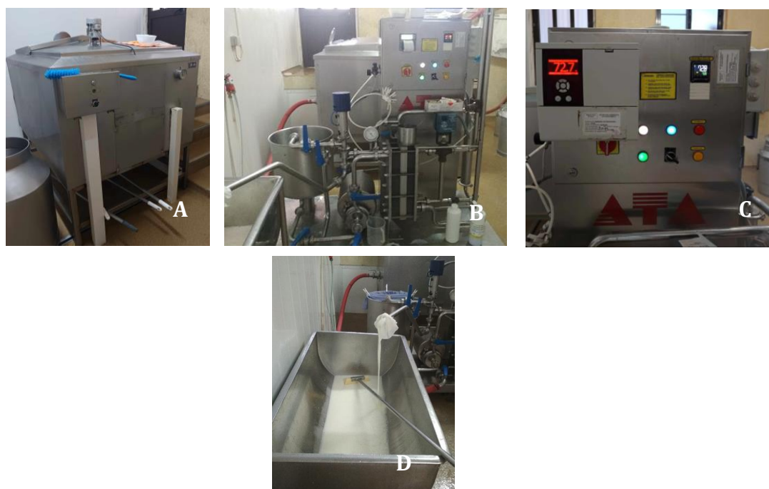
Figura 9- Tanque de Refrigeração (A); Pasteurizador (B e C) e Saída do leite para os tanques (D)
