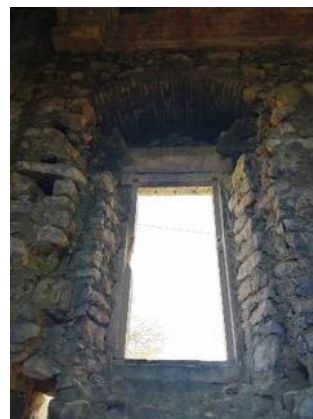
Figura 37- Fissuras de gradeamento das janelas, ano de 2020; Fonte: Mariana Vieira.
