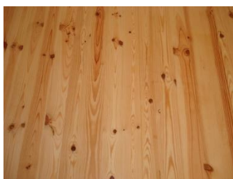
Figura 19 - Soalho de madeira de pinho
