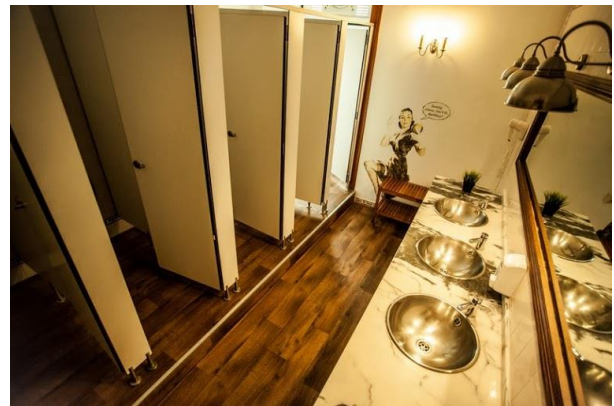
Figura 14 - Home Lisbon Hostel – Instalação Sanitária
