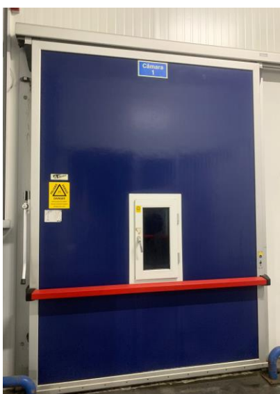
Figura 17- Porta da camara de atmosfera controlada
