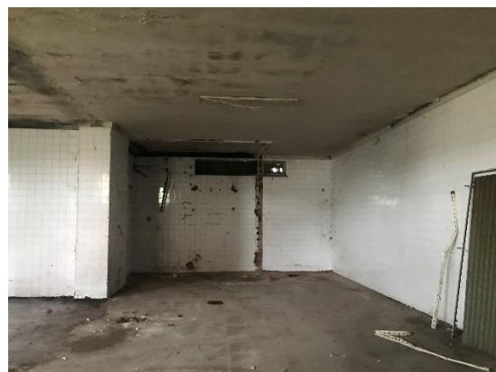
Imagem 19- Vista com alguns pormenores da parte De trás do interior do edifício
