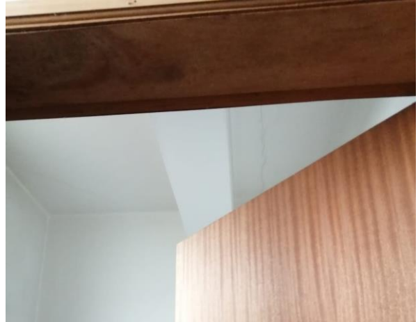
Figura 112 - Viga no teto do WC. Fonte: Autor
