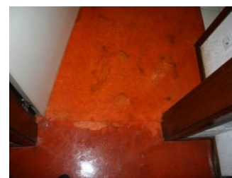
Figura 47- Degradação do pavimento vinílico
