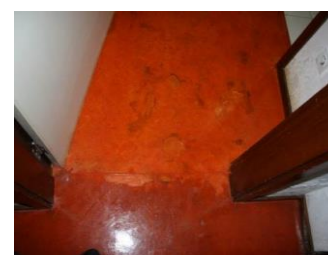
Figura 20- Degradação do pavimento vinílico
