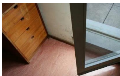
Figura 46- Degradação e desgaste dos equipamentos
