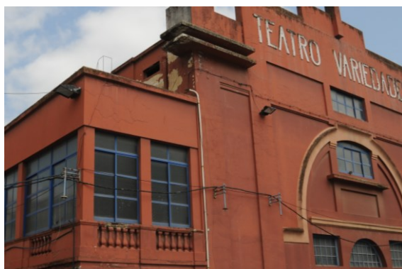
Figura 14 - Patologia nas janelas Fonte: RUIN'ART
