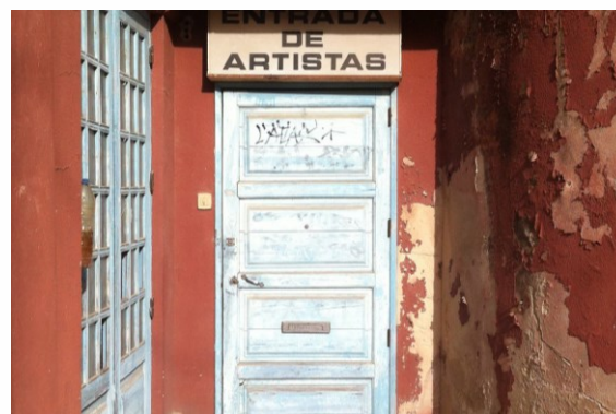
Figura 15 - Patologia nas portas Fonte: RUIN'ART
