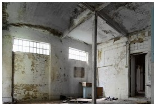
Figura 20 - Patologia nas paredes interiores Fonte: RUIN'ART
