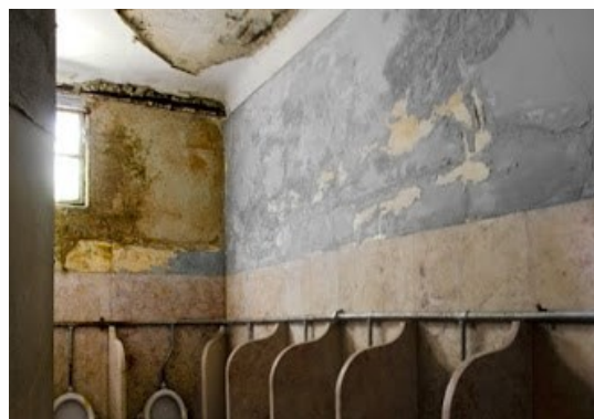
Figura 21 - Patologia nas paredes interiores Fonte: RUIN'ART
