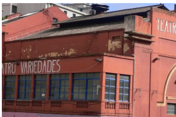
Figura 8 - Patologia nas paredes exteriores zona lateral esquerda Fonte: RUIN'ART
